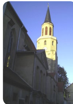
An der Glocke der Coswiger Kirche St. Nicolei wurde ein Haarriss repariert.
